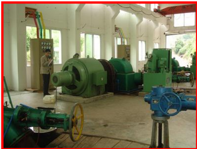
Электростанция лянчахэ, уезд Мабянь , провинция Сычуань
